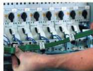
Надежная установка и электромонтаж
